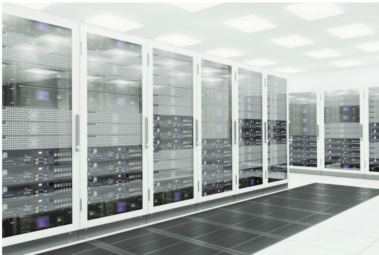
Bilden föreställer en av Infracoms datahallar. Här förvarar och drifftar bolaget kundernas servrar. Foto: Infracom
